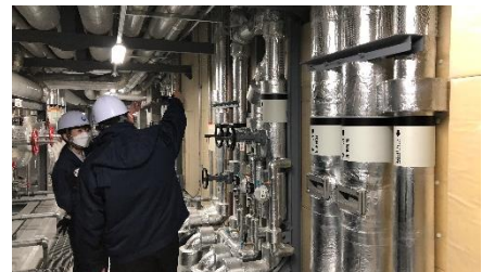
災害用汚水槽バルブ切り替え箇所確認の様子
